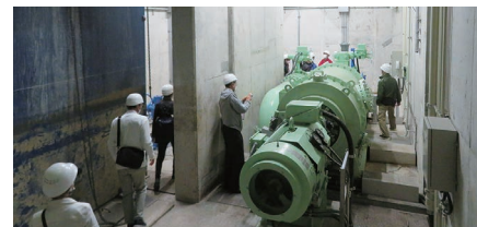
▲丸山ダム 発電機
